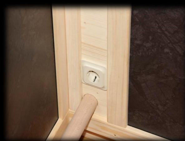
Prises électriques intérieures
